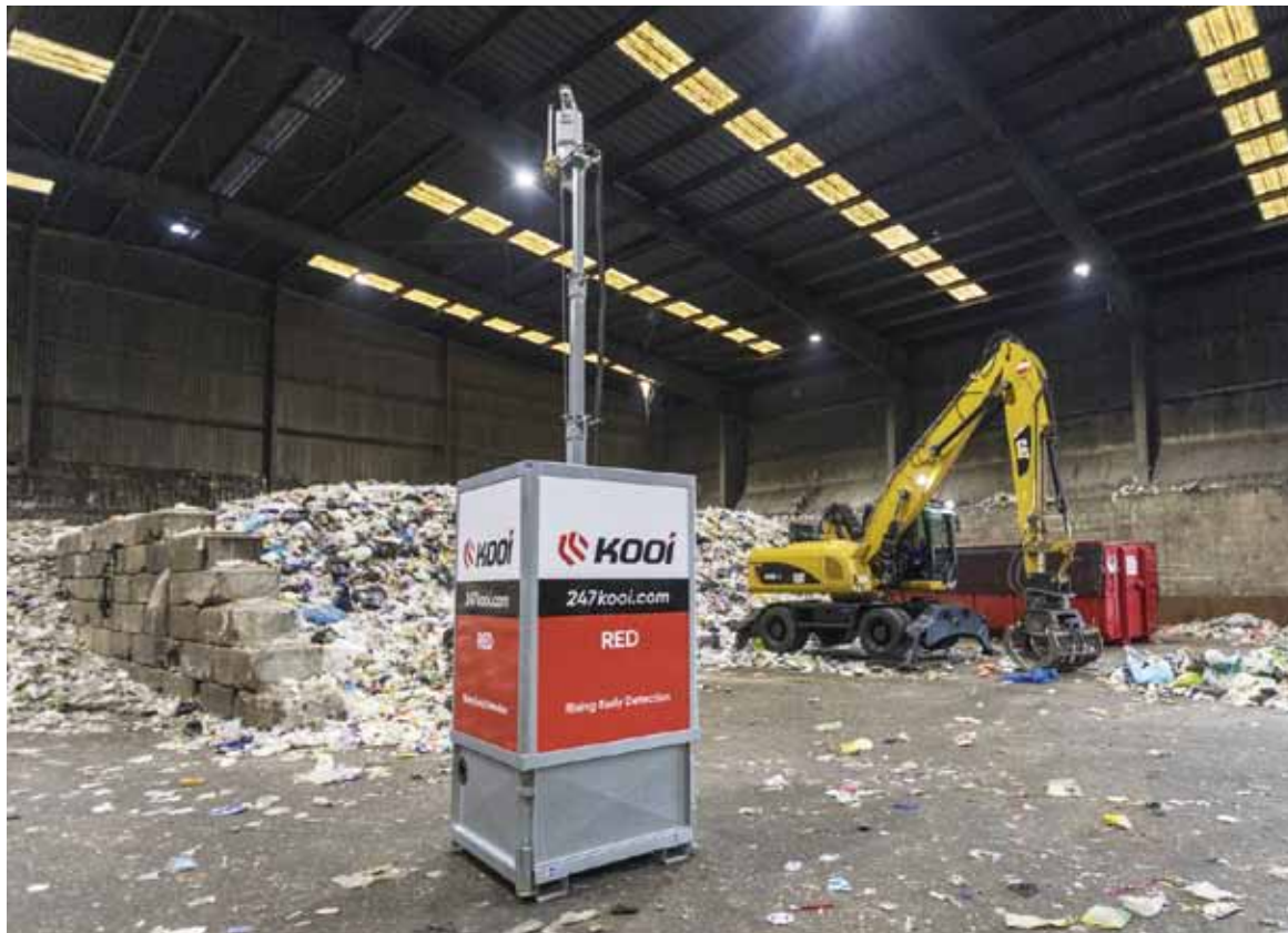
Ein RED von KOOI im Einsatz in einer Halle zur Müllsortierung und -lagerung; damit hier kein Brand ausbricht, wacht das System über die richtige Temperatur in den Abfallbergen. Wird's zu heiß, schlägt RED Alarm.
